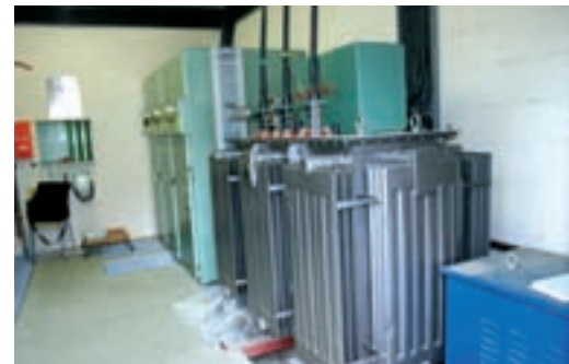
Transfo HT/BT et cellules protections
