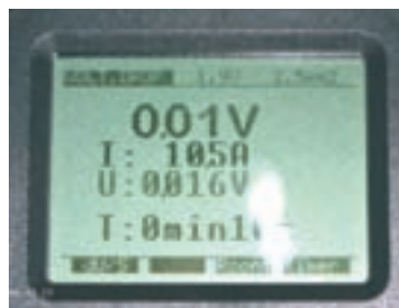
Entre le PE du connecteur et les différentes parties de l'armoire électrique de la station de pompage
