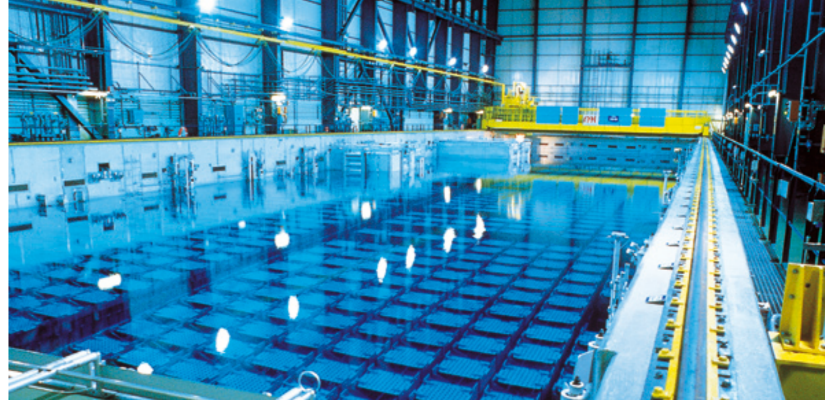
Piscine d'entreposage des combustibles usés.
