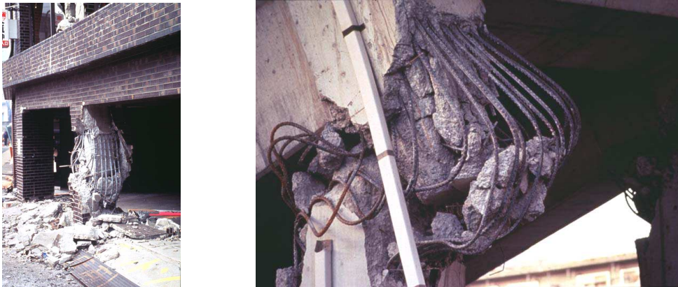
Figure 20 : Effondrement de poteaux en béton armé du fait de manque de renforcements ; à gauche, par compression excessive ; à droite par cisaillement de la liaison avec une poutre.
