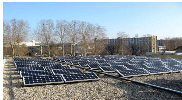
Figure 13 : vue de l'installation Hespul/LaNef. Pose en toiture terrasse.
