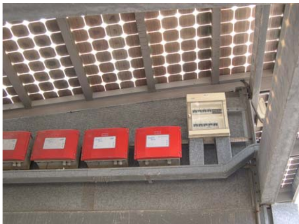
Figure 26 : installation P.V sur un bâtiment de la mairie
