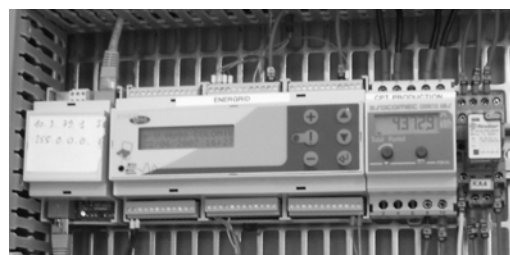
Figure 19 : Centrale Energrid IP, compteur et relais TOR
