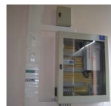
Figure 2 : Armoire de distribution
