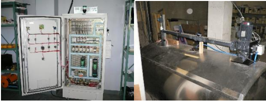
Figure 3 : Armoire électrique et partie opérative
