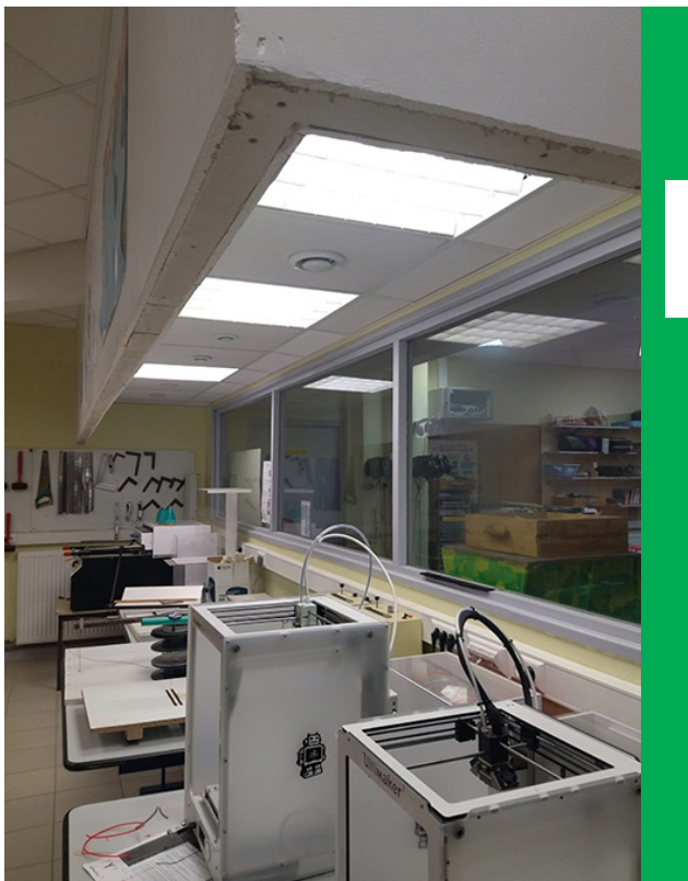
Hotte aspirant les COV des imprimantes 3D, fers à souder, etc. Collège Reverdy à Sablé sur Sarthe
