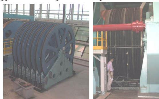
Figure 11 : Train de poulies des câbles de suspension (a), et treuil d'enroulement des câbles de commande
