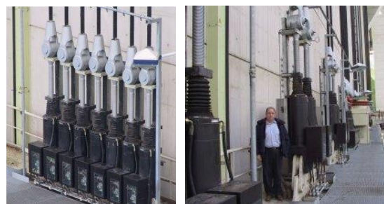
Figure 10 : Tendeurs des câbles de suspension (a), tendeurs des câbles de commande (b)
