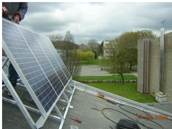
Figure 3 : Panneaux solaires installés
