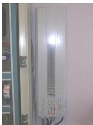
Figure 6 : Onduleur 230 V – 50 Hz installé
