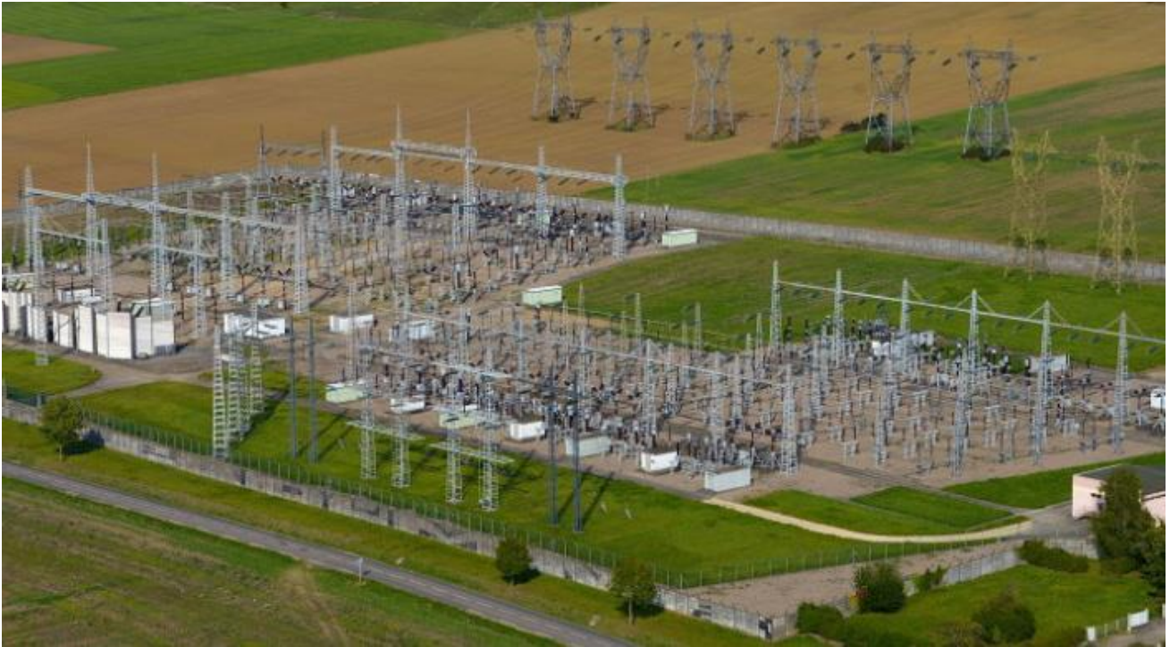
Figure 9 : Poste électrique, source [8]
