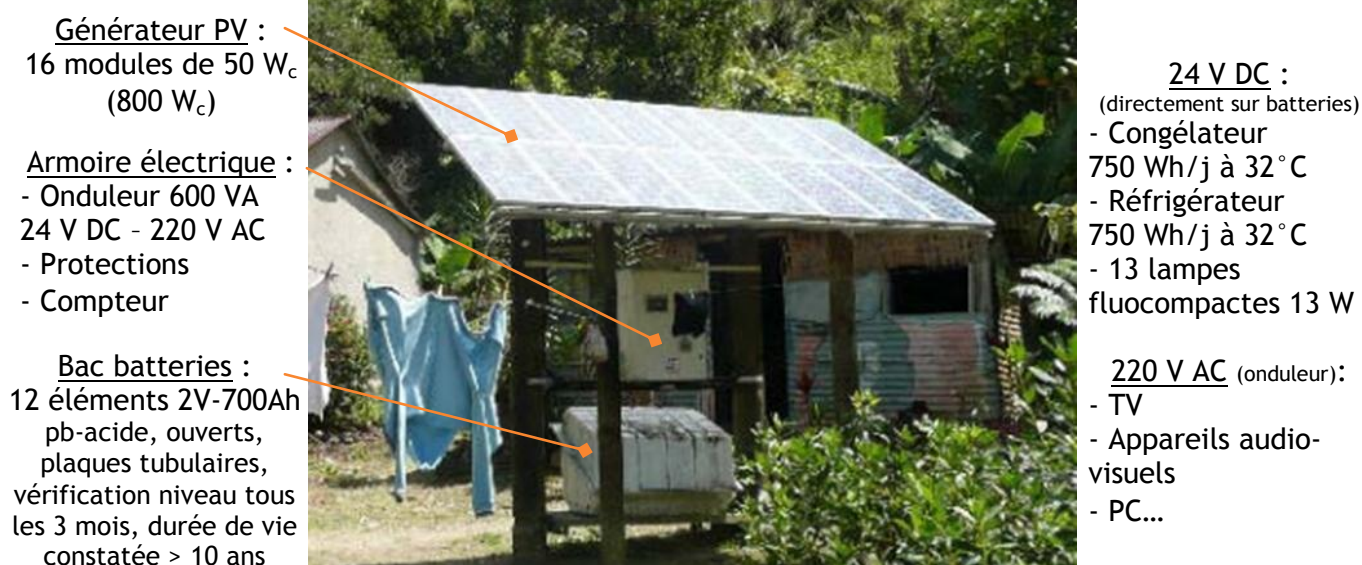
Figure 58 : Installation autonome Enercal en Nouvelle-Calédonie, source B. Multon
