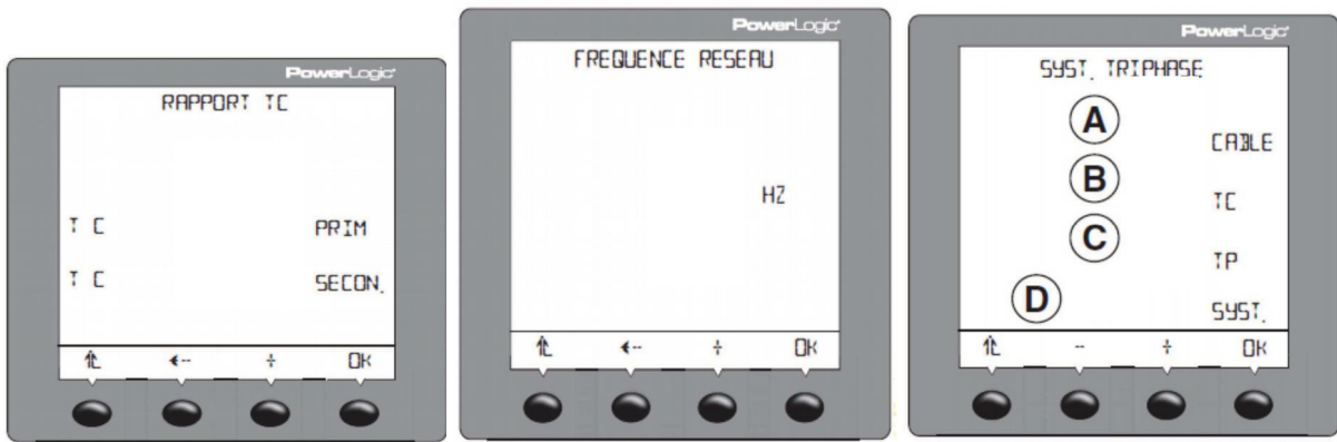
Figure 4 (DRE2) Configuration de la centrale de mesure
