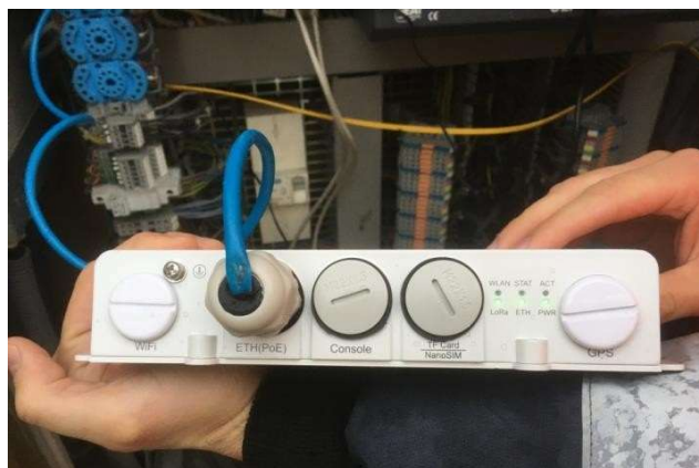
Photo de la passerelle LoRa (face arrière) avec sa connexion au réseau Ethernet de la ville de TROYES
