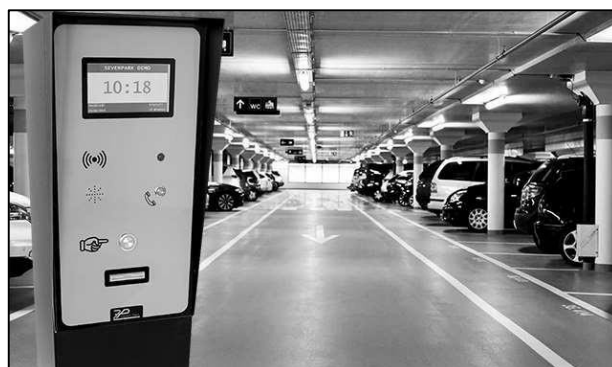
Figure 1 : système de contrôle d'accès
