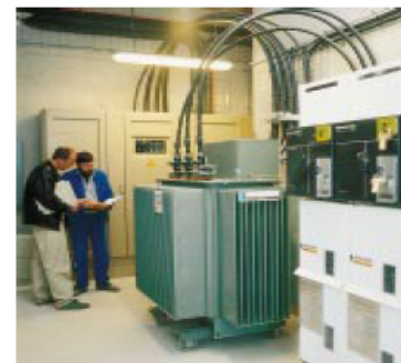
800 kVA - 20 kV / 400 V
