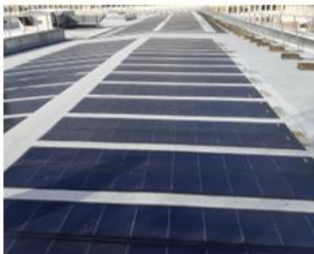
Panneaux Photovoltaïques Toit terrasse
