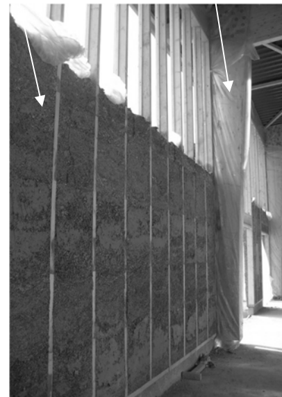
Photo montrant un poteau porteur et les parois en béton de chanvre durant la construction
