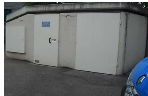
Poste connecté à la ligne HTA qui passe au dessus du chantier. Il alimente l'ensemble pavillonnaire
