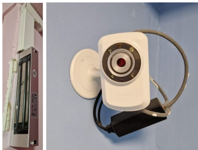
Figure A2 : ventouse permettant l'ouverture d'une porte (à gauche) et caméra IP permettant le suivi de la partie (à droite)
